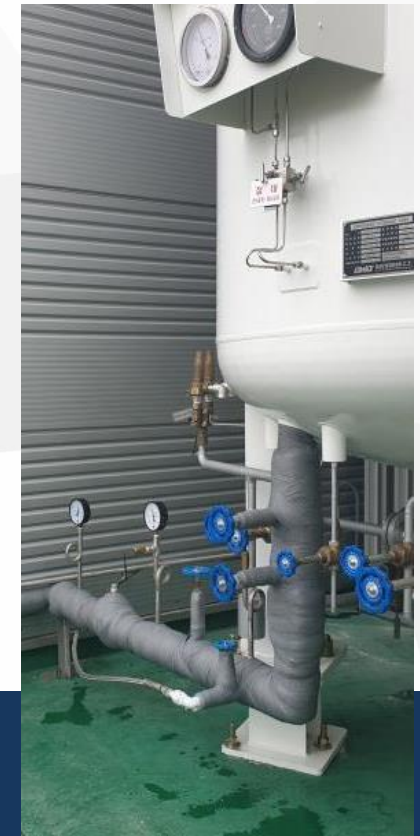
▲ 옥외 액체질소 저장 탱크 및 보온 배관라인
