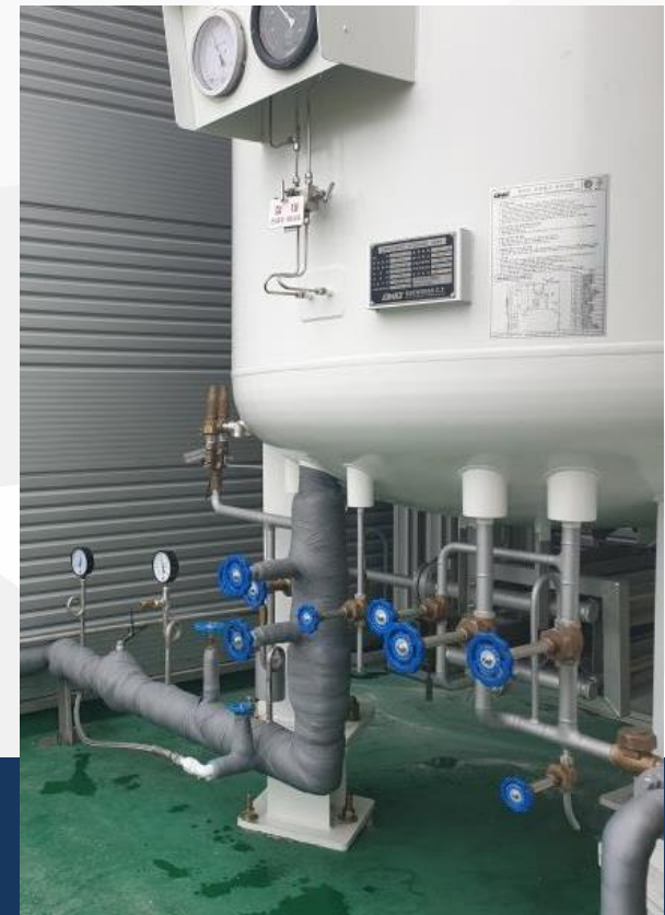
▲ 옥외 액체질소 보관 탱크 및 보온 배관라인
